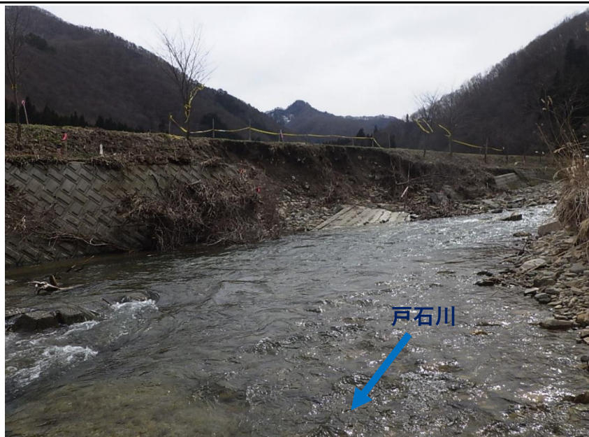
被災状況（令和2年3月25日撮影）
