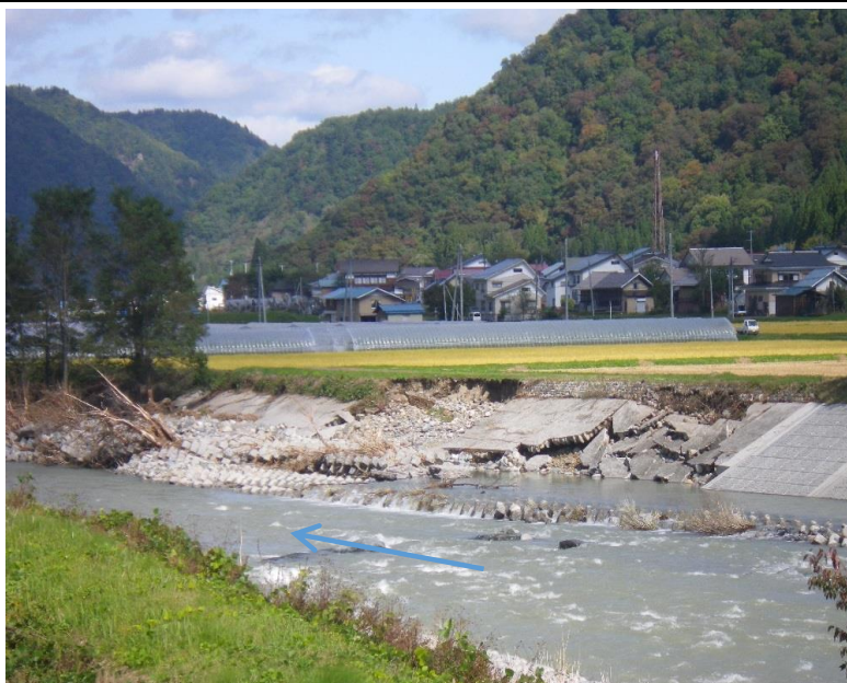
被災状況（令和元年10月15日撮影）
