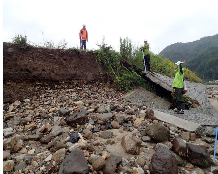
被災状況（令和元年10月15日撮影）
