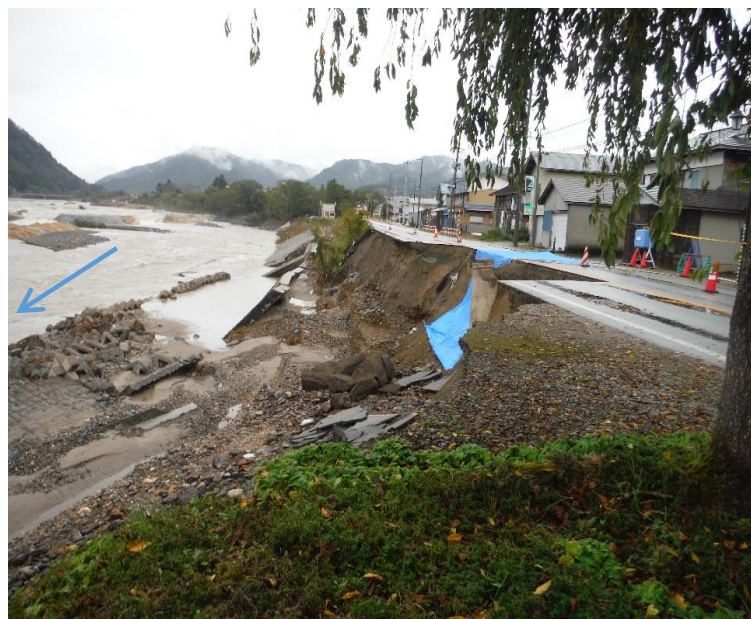
被災状況（令和元年10月15日撮影）
