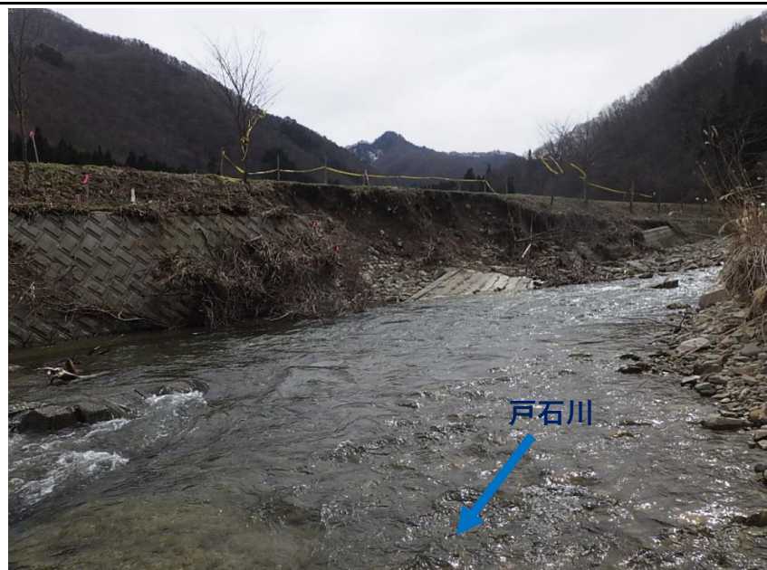
被災状況（令和2年3月25日撮影）
