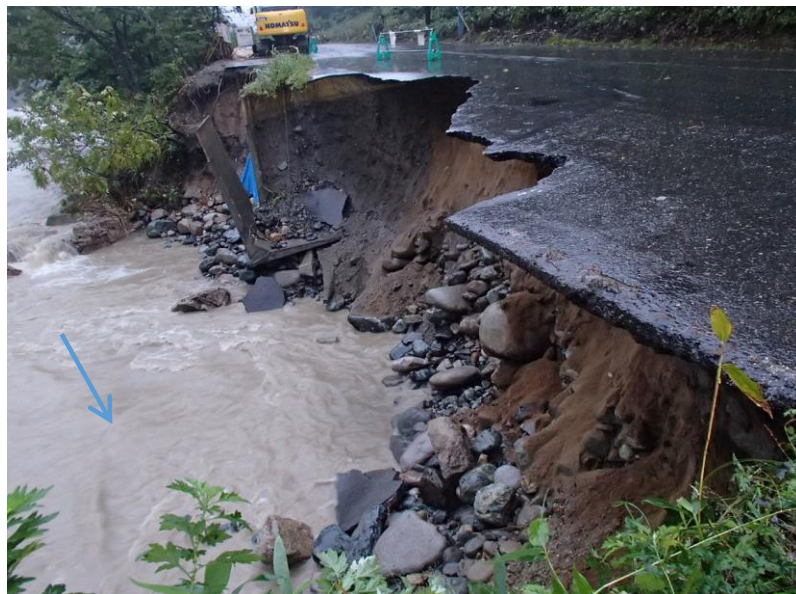
被災状況（令和元年10月13日撮影）
