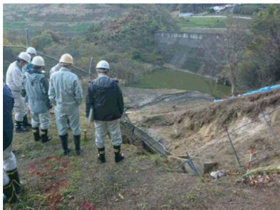
災害査定実施状況
