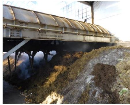
(猪苗代町優良堆肥製造施設・オープン昇降式 攪拌機)
