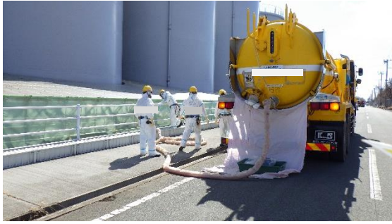
(写真3-3) 吸引車回収水の移送状況 (K2タンクエリア北西側) (北側から撮影)
