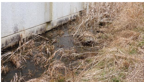
(写真5) フェーシングされていない箇所 の様子
