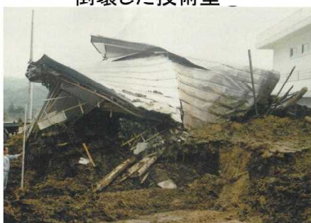
倒壊した技術室
