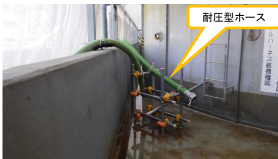
(写真5-1) K1北タンクエリア西側付近 (物揚場排水路の水の回収用耐圧型 ホース据え付け状況)
