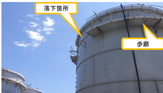
(写真2) 歩廊の落下の状況 (落下した歩廊は撤去済み)
