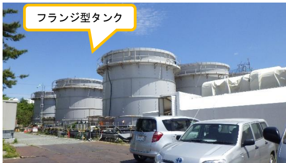
(写真1) F1タンクエリア北西側 (フランジ型タンク設置状況)
