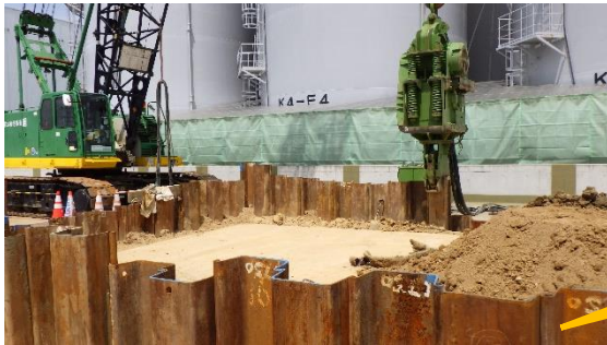
(写真2) 地盤掘削の状況 (両発進立坑) (南側から北側に向かって撮影)
