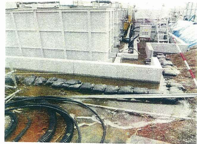
漏えいの状況 (①エリア)
