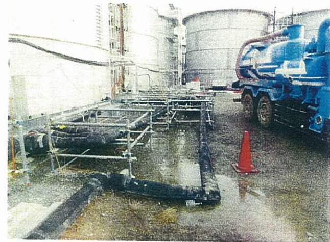
漏えいの状況 (③エリア)
