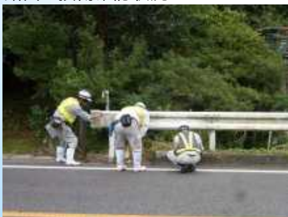
路面の損傷確認状況
