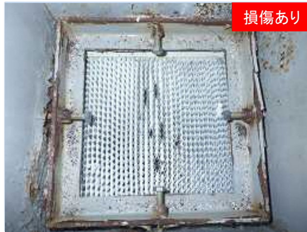
増設ALPS 排水タンク排気フィルタ
