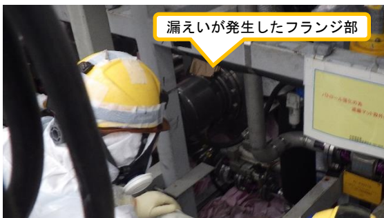
(写真1-2) 漏えいが発生したフランジ部の状況
