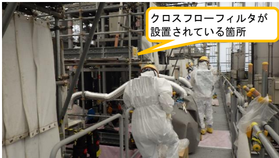
(写真1-1) 既設多核種除去設備内の状況 (漏えいが発生した付近の状況)
