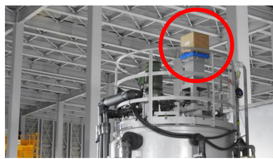
（写真2）増設ALPSにおけるタンクの代替フィルタ（赤丸）
