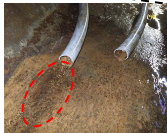
湧水箇所 (導水パイプ)
