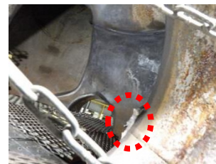
仮設灰処理施設(その2)損傷状況
