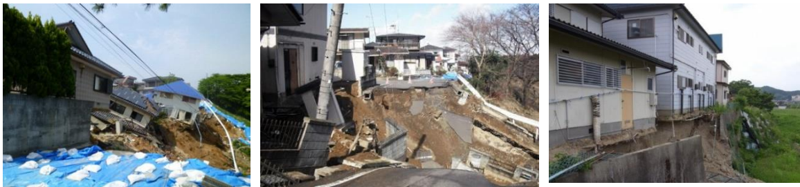
【法面や擁壁の被害状況（東日本大震災）】
