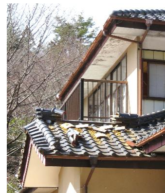
【屋根瓦の被害状況】
