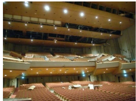
【天井落下被害の状況】
