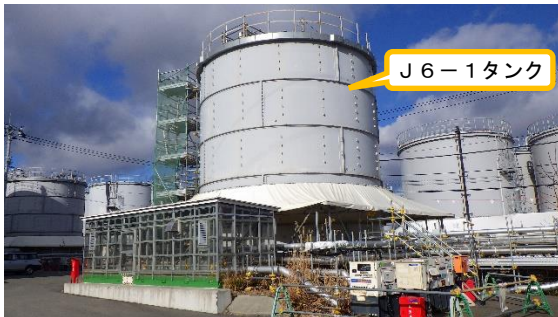
(写真1-1) J6-1 雨水回収タンクの外観 (南東側から撮影)
