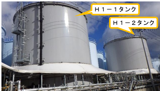
(写真1-4) H1-1～2雨水回収タンクの外観（南西側から撮影）
