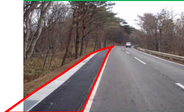
<側溝の位置を工夫して路肩を広げた状況> 国道289号(西郷村)
