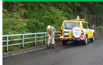
<パトロールで発見した損傷箇所を応急処置>
