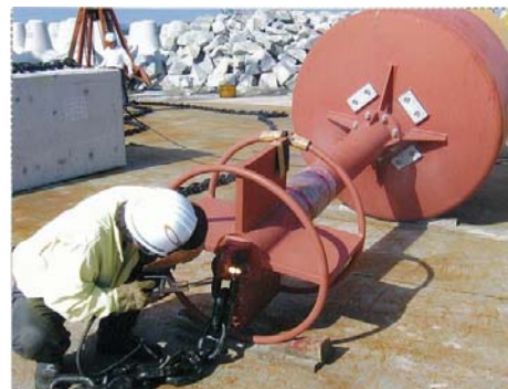
波高計の点検
