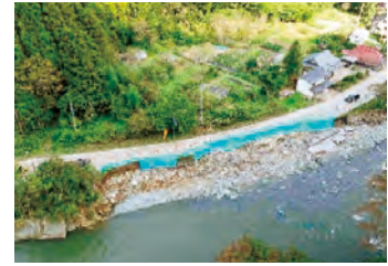
いわき石川線(才鉢)被災状況
