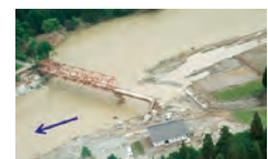
只見川の被災状況
