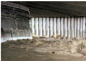
喜多方西会津線 (峯) 被害状況
