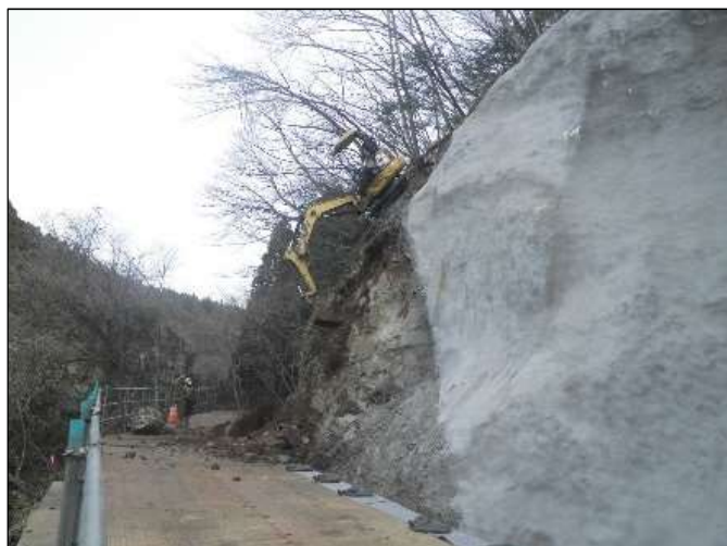
【復旧状況 本復旧工事開始 R3.1~】 (無人掘削機による急斜面の追加掘削)
