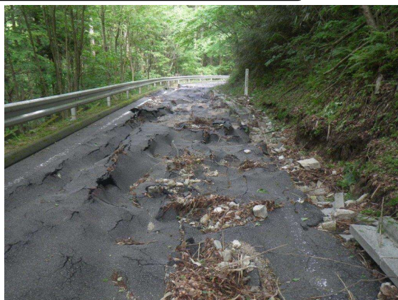
【被災状況 林道崩壊】
