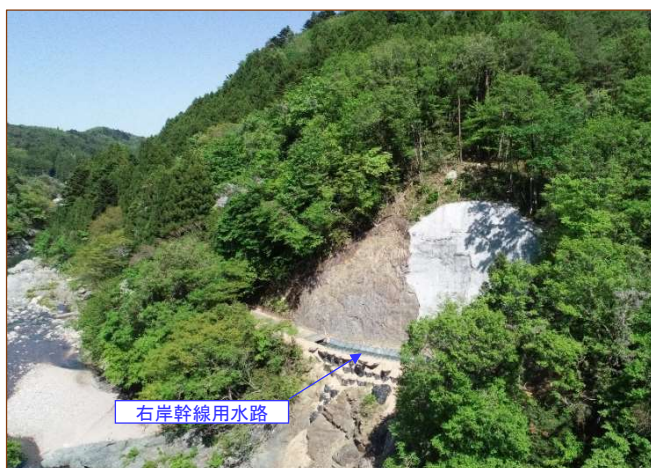
【復旧状況 R3.5.7】 (コンクリート水路の本復旧に向け 法面保護工を実施中)
