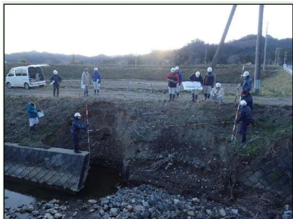
現地査定[排水路](浪江町)
