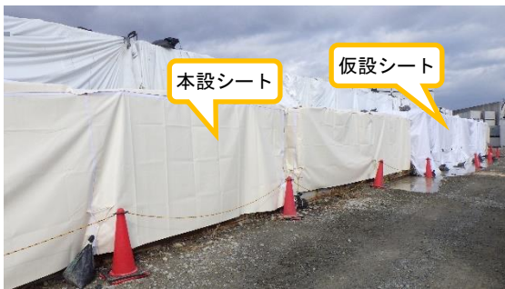
(写真2) 一時保管エリアP2のシート養生の状況(南東側から撮影)
