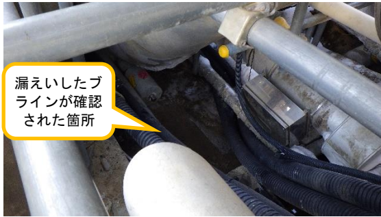
(写真2) 漏えいしたブラインが確認された箇所の状況
