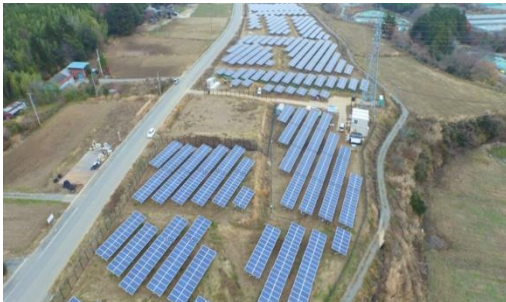
大熊町ふるさと再興メガソーラー発電所
