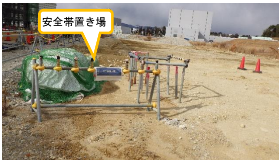
(写真2) 現場に設置された安全帯置き場の状況
