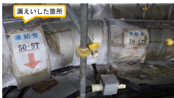
(写真 4 - 1) ブラインが漏えいした凍結管付近の状況 (令和 4 年 1 月 27 日撮影)
