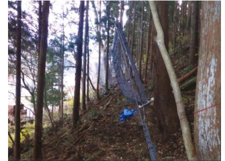
高エネルギー吸収型 落石防止柵工
