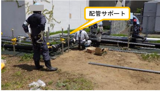
(写真1-1) 5号機原子炉建屋周辺における配管サポート設置作業の状況 (西側から撮影)
