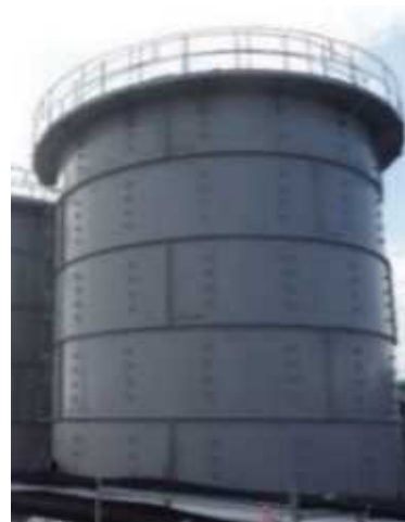
フランジ型タンク
