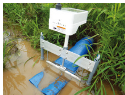
自動水門による水管理
