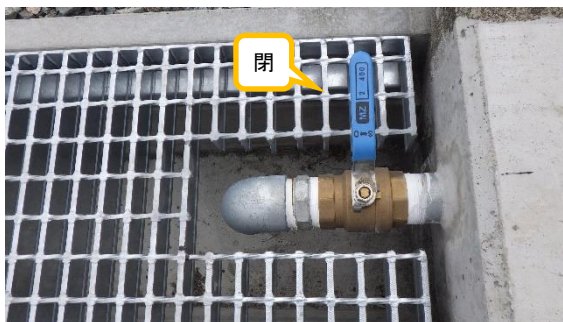
(写真 4) 排水弁の例 画像はNo. 1 Cのもの
