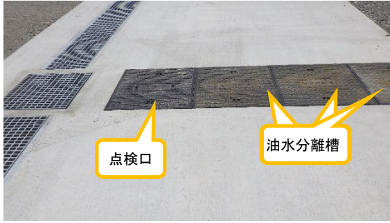
(写真 2) 油水分離槽及び点検口の設置状況の例 画像はNo. 1 A及びBのもの
