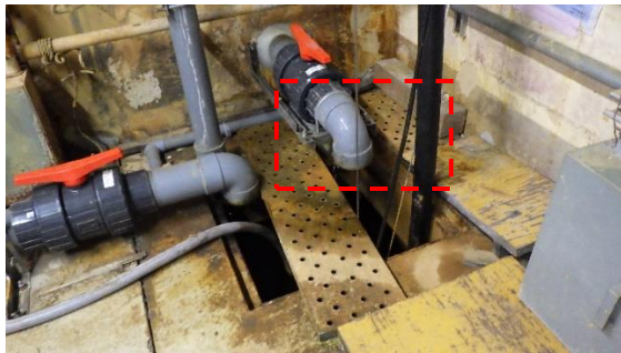
(写真3-1) 地下水流入箇所 (6号機タービン建屋地下階南西側)
