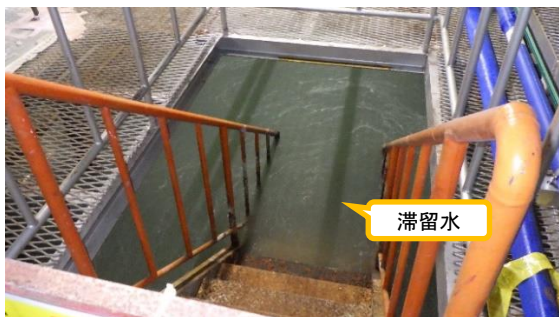
(写真3-3) 6号機タービン建屋地下階の滞留水の状況 (前回(令和3年4月19日)撮影)
