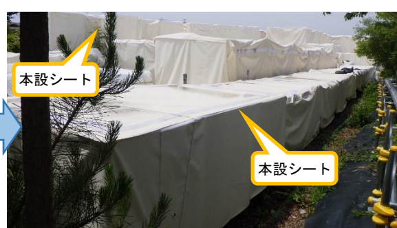
(写真2-2) 一時保管エリアW1の本設シート養生の状況(2)(今回(6月1日)エリア北側を東側から撮影)
