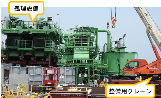
(写真1-3) 泥水処理設備の整備状況① 1次・2次処理を行う設備 (南側から撮影)
