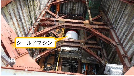
(写真2) 放水立坑（下流水槽）内に保管されているシールドマシンの状況 (西側から撮影)
