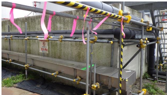
(写真5-1) 軽油タンク防油堤南西側外壁の配管敷設状況 (南西側から撮影)
