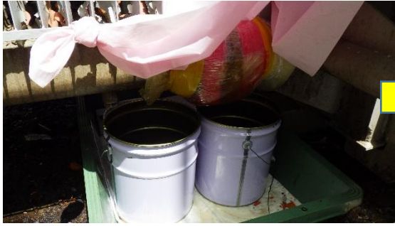
(写真 1 - 1) 漏えい箇所の養生状況 (前回(4月25日)撮影)
