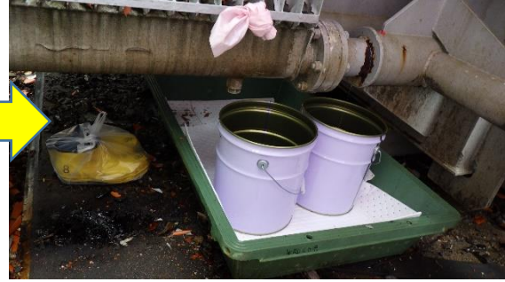
(写真 1 - 2) 漏えい箇所の状況 (今回(4月26日)撮影)
