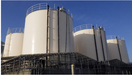
(写真 2 - 1) 増設／高性能多核種除去設備 サンプルタンク外観 (北東側から撮影)
