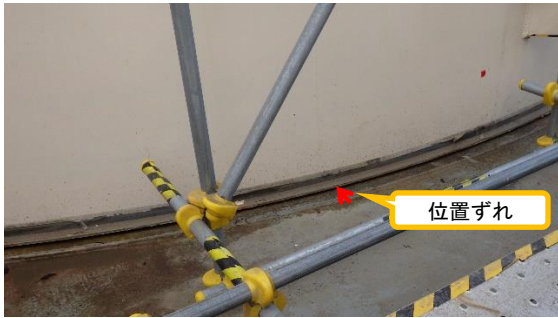
(写真 2 - 2) 位置ずれがあったタンクの一例 (高性能多核種除去設備 サンプルタンク (C) )
