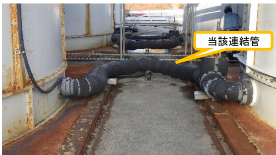
(写真1-2) 保温材内部に溜まり水が確認された 連結管 (Fタンクエリア)
