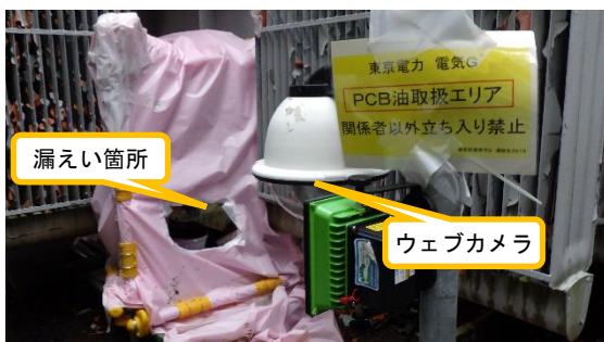
(写真3) 油漏えい箇所における遠隔での監視 状況
