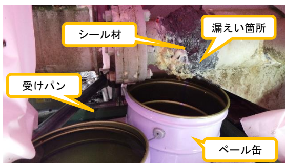
(写真2) 油漏えい発生箇所の状況
