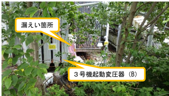
(写真1) 油漏えい発生箇所周囲の状況
