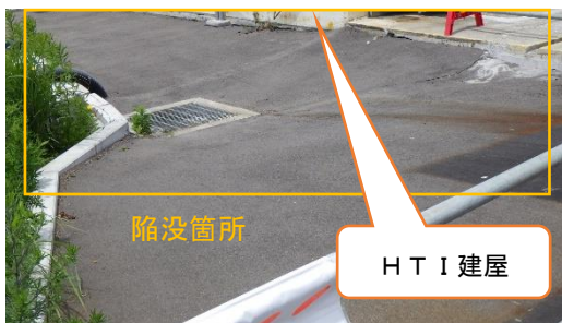
(写真3-2) 陥没の状況
