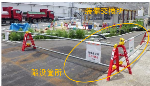
(写真3-1) 陥没箇所の区画の状況
