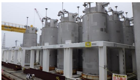
(写真1-2) 第一施設における架台に置かれた吸着塔の状況
