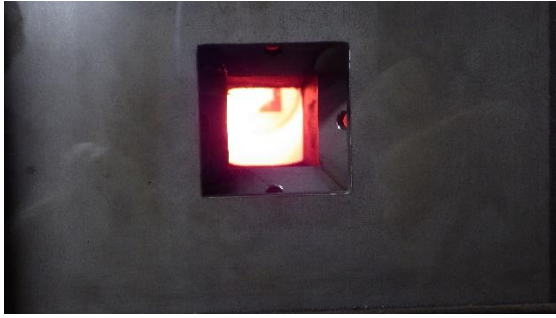
(写真1) 焼却炉（B系）のロータリーキルン での廃棄物の燃焼の状況
