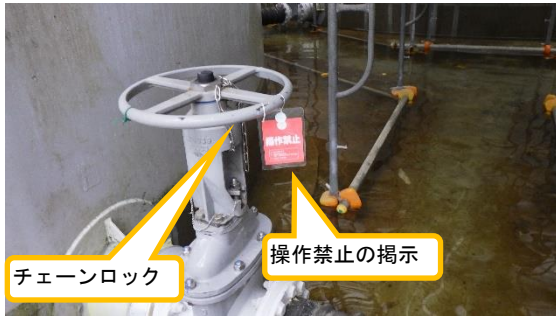
(写真 2 - 2) 連結弁ハンドル部分の状況
