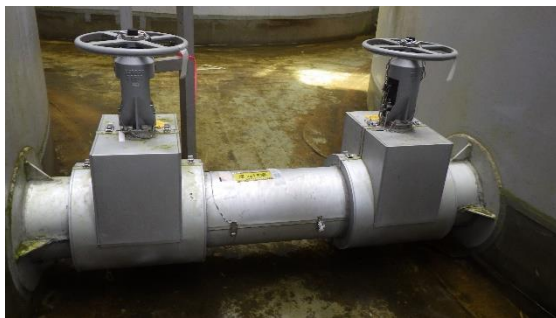
(写真 2 - 3) 保温材が設置されている連結管の例
