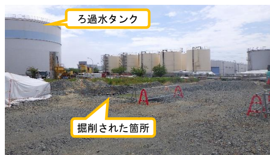
(写真1-2) エリア整備作業の状況② (北西側から撮影) (令和4年6月24日撮影)
