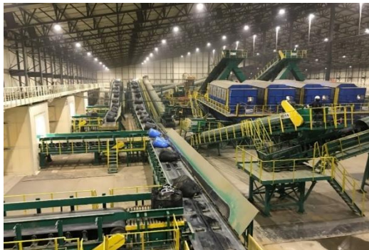
受入・分別施設(稼働中)
