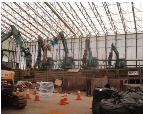
受入・分別施設(稼働中)
