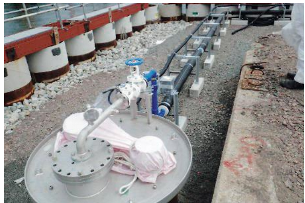
海側遮水壁と地下水ドレンポンド
