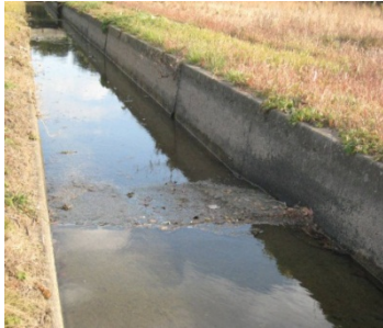
底版が隆起した水路
