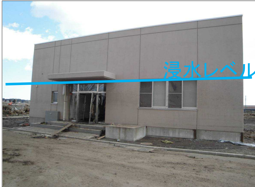
写真1-1 管理棟損傷状況
