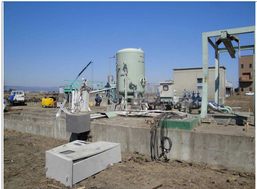
写真2-1 水処理施設損傷状況
