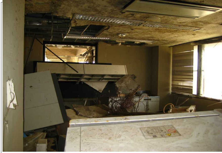
写真3-1 管理棟内部被災状況
