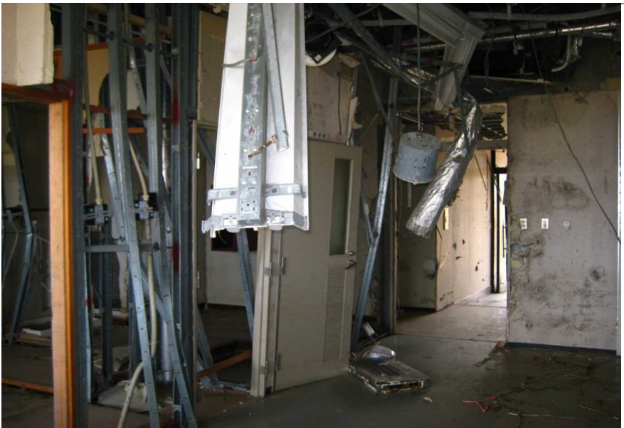
写真4-1 管理棟内部被災状況
