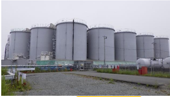
(写真4-1) Dタンクエリア濃縮廃液貯留タンク群の概観（北西側から撮影）
